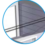
Potrubí s chladivem
